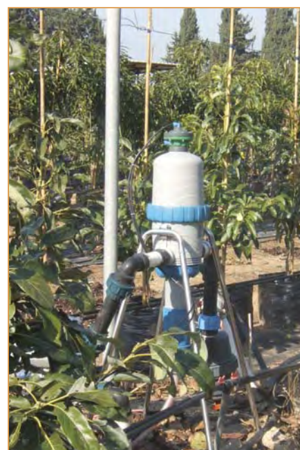
Modello TF 25 installato
