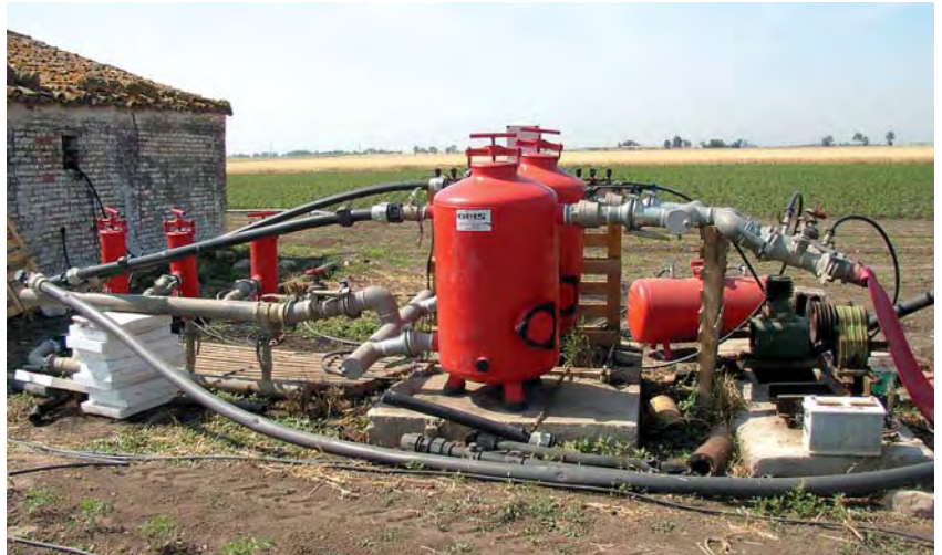
Impianto di filtrazione
